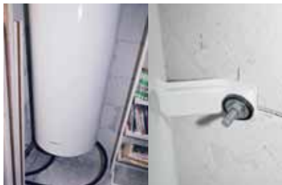
Fixation d'un réservoir d'eau chaude de 350 litres avec 4 fixations chevilles nylon haute adhérence
